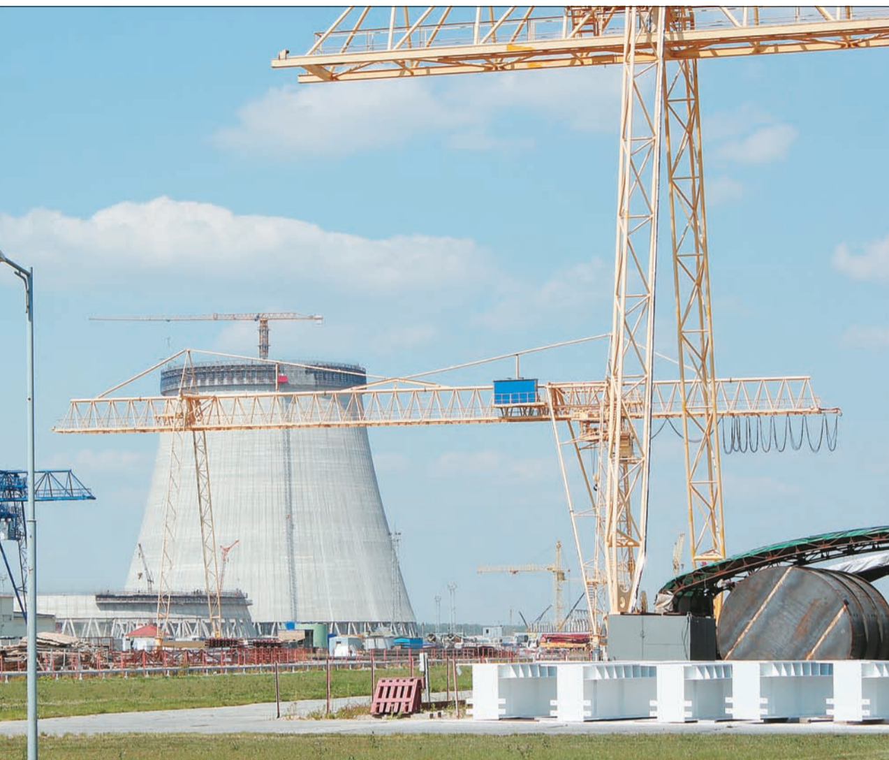
Градирня первого энергоблока, возвышающаяся сегодня более чем на 80 м над землей, видна еще на подъезде к месту строительства АЭС
